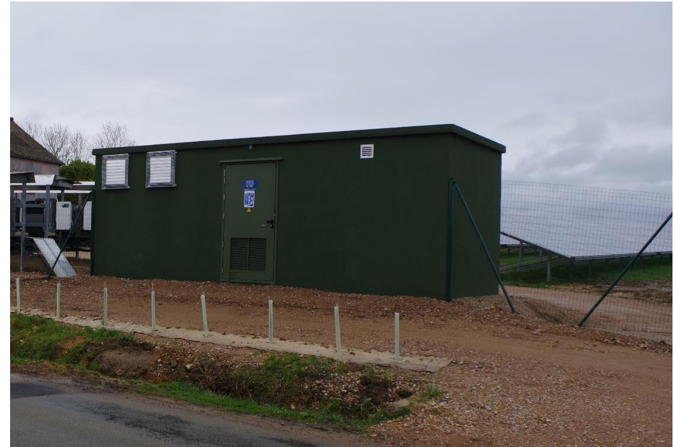
Figure 74 : Exemple de poste de livraison (source : Arvro Energies, 2023)
